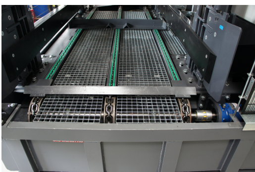
Ölauffangwanne mit begehbaren Gitterrost-Segmente abgedeckt, inkl. Niveauüberwachung
