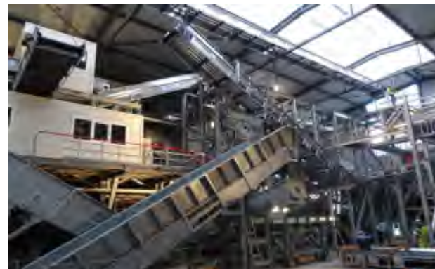
Bunkeranlage, Sichter und Handsortierung im Januar 2015
