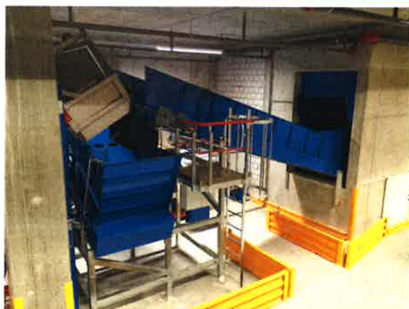
Kettengurtförderer als Abfuhrband vom Pressenschacht.
