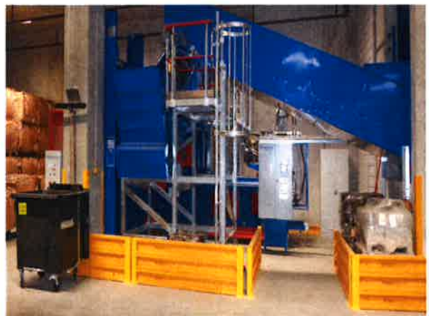
Anfahrtschutz für Hubstapler, erstellt als Leitplankensystem.
