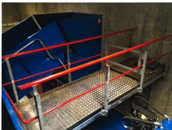
Einfache Zugänglichkeit aller wichtigen Komponenten der Anlage über Wartungspodeste.
