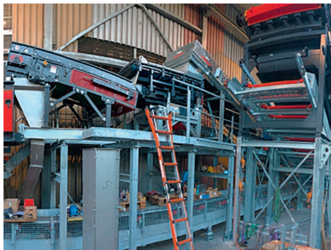
Montage Siebstufen / NE-Metallabscheidung
