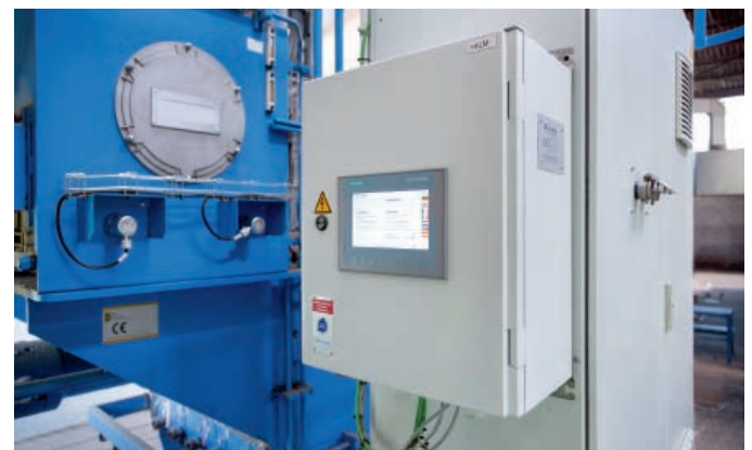
Das ALM-Logikmodul ist die zentrale Überwachungseinheit
