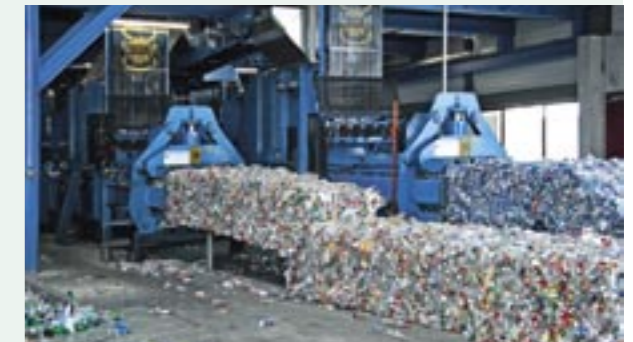
3 Stück Ballenpressen für die Verdichtung des sortierten PET-Materials zu schweren, handelsüblichen Ballen
